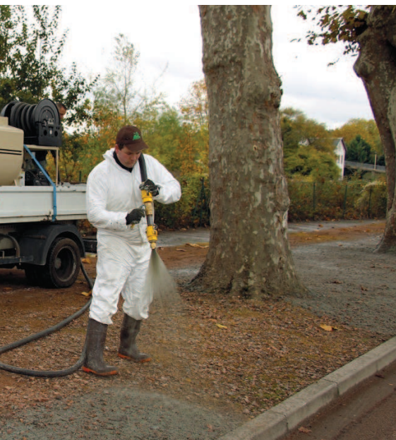
Végétalisation d'une portion d'allée sur un boulevard de Fourchambault (Nièvre) par l'entreprise PEV, en novembre 2016, avec un hydroseeder T30 de marque Finn.
